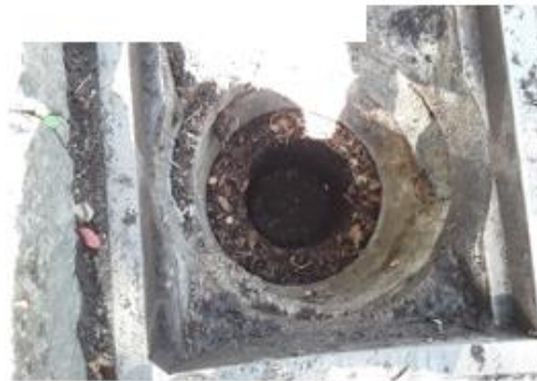
Straßeneinlauf mit defekten Betonunterbau und verstopfter Leitung
