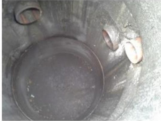
Sickerschacht noch in gutem Zustand vor der Reinigung und Regenerierung der Filterschicht
