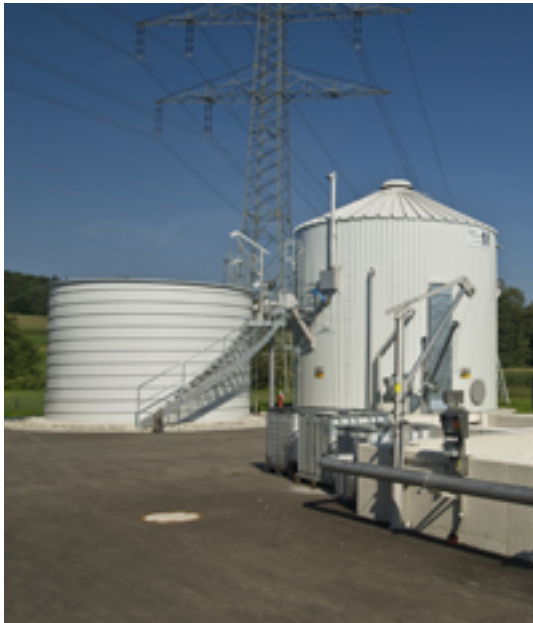
Abbildung 4: Wickelfalz-Faulbehälter zur anaeroben Schlammstabilisierung mit integriertem Gasspeicher (optional)
